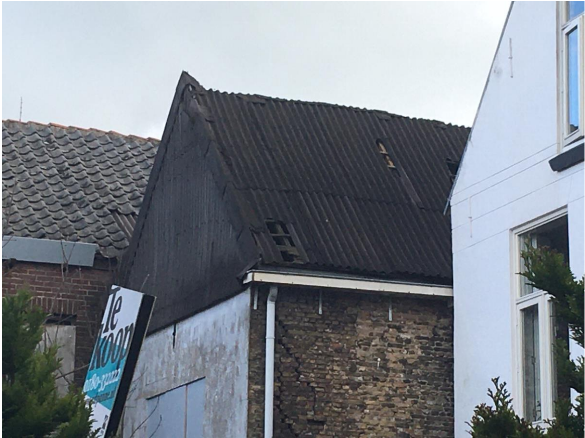
Foto 1 Zijvlak dak met beschadigde bitumineuze golfplaten
